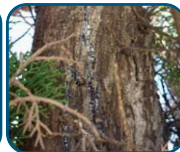
Exsudação de resina devido ao cancro no Cipreste
